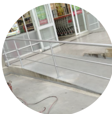
CAMBIO DE BARANDA HACIA EL D1 LA CUAL SE ENCONTRABA TOTALMENTE OXIDADA
